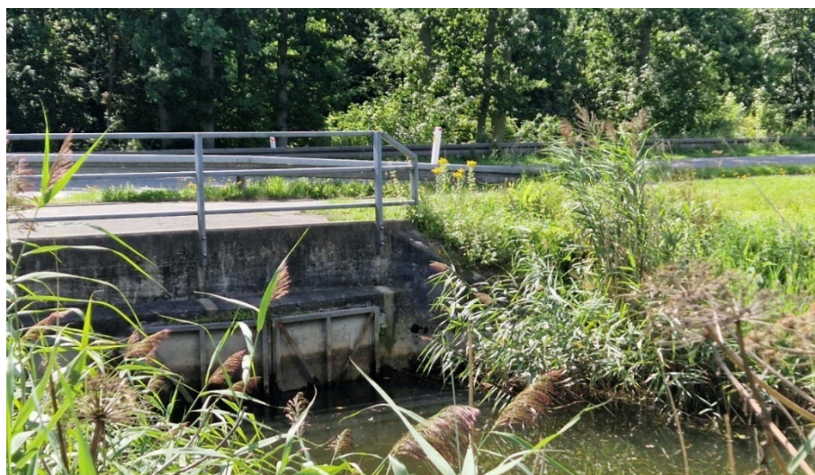
Figur 2.5. Odder tvinges op over vejen med risiko for trafikdrab, når der installeres højvandsluser eller andre blokeringer under vejbroer i forbindelse med klimasikring af lavtliggende områder (Foto: M. Elmeros).
